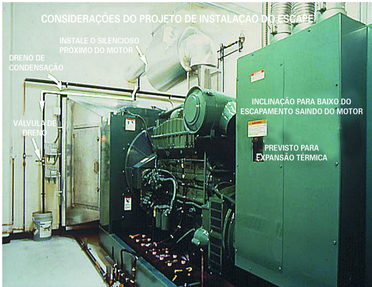
Figura 6-5: Características Típicas de um Sistema de Escape para um Gerador Instalado Dentro de um Edifício
