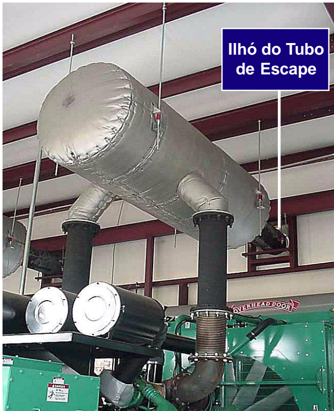
Figura 6-7: Características do Sistema de Escape do Grupo Gerador. São mostrados: Silencioso com Dupla Entrada, Conectores Flexíveis, Ilhós da Tubulação de Escape e Ganchos de Montagem.
